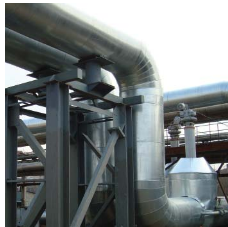
Системы вентиляции, кондиционирования и трубопроводы
