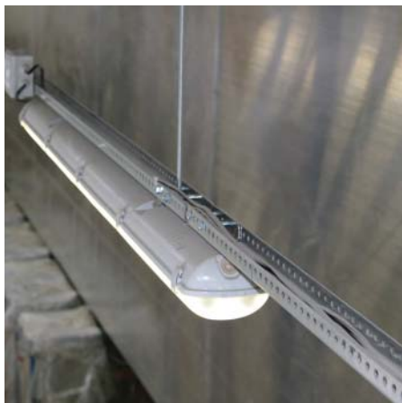
Подвес светильника на профиле и шпильке
