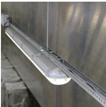
Подвес светильника на профиле и шпильке
