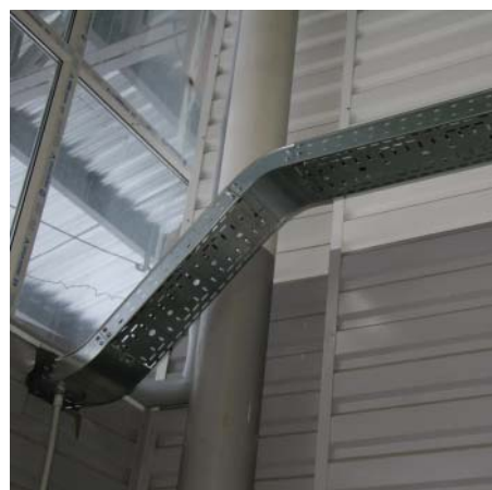
Изменение уровня кабельной трассы
